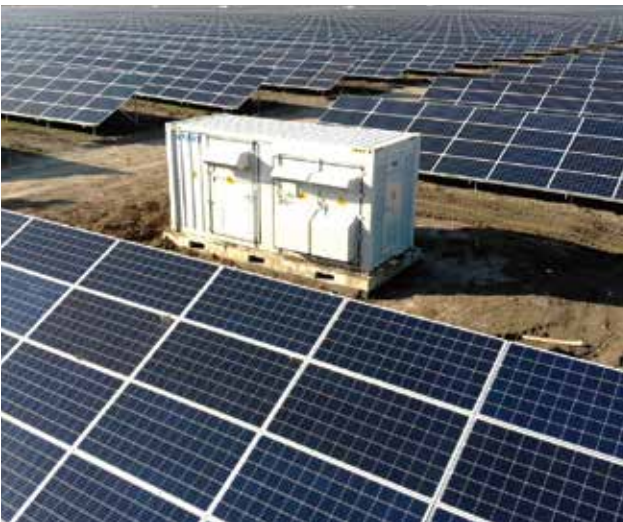
07 Usina Fotovoltáica de larga escala de 200 MW na Ucrânia
