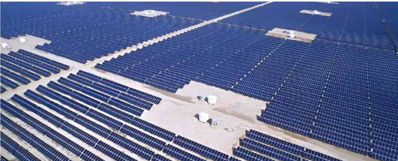
04 Usina Fotovoltáica de larga escala de 900 MW no Paquistão
