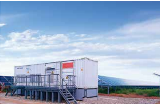
02 Usina Fotovoltáica de larga escala de 300 MW na Rússia
