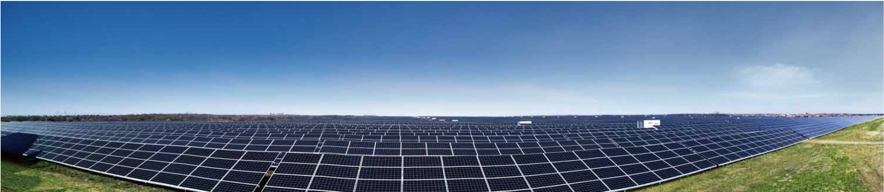
01 Usina Fotovoltáica de larga escala de 240 MW na Ucrânia
