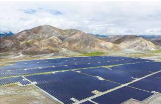
05 Usina Fotovoltáica de larga escala de 4747m Altitude no Tibete
