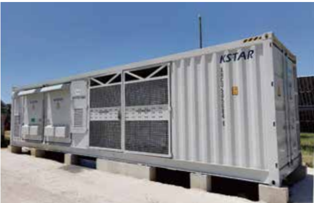
03 Usina Fotovoltáica de larga escala de 10 MW na Espanha
